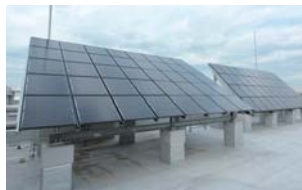
E棟の屋上に設置している太陽光パネル
