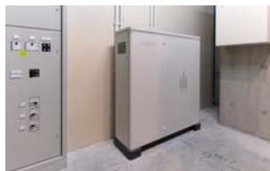
E棟に設置している蓄電池とコントロールパネル
