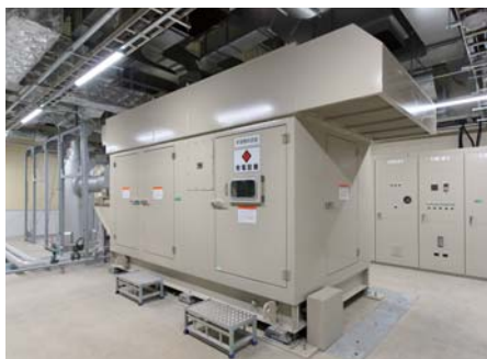
R3棟の機械室に設置しているガスコージェネレーション本体
